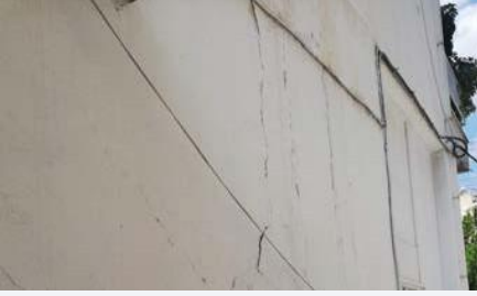
2019'daki depremden sonra Palaio Faliro'daki okul binalarının yapısal elemanlarında çatlaklar
